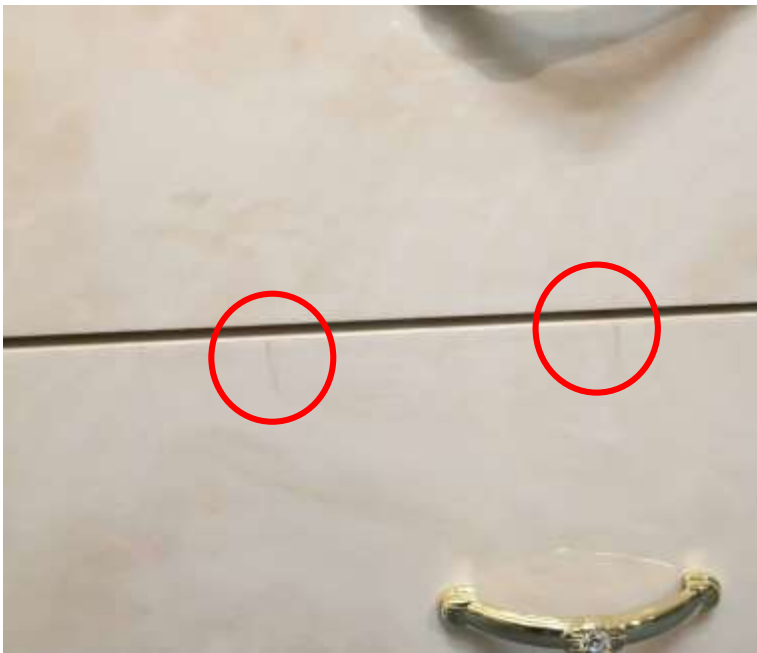
前面汚れ 2箇所あり
